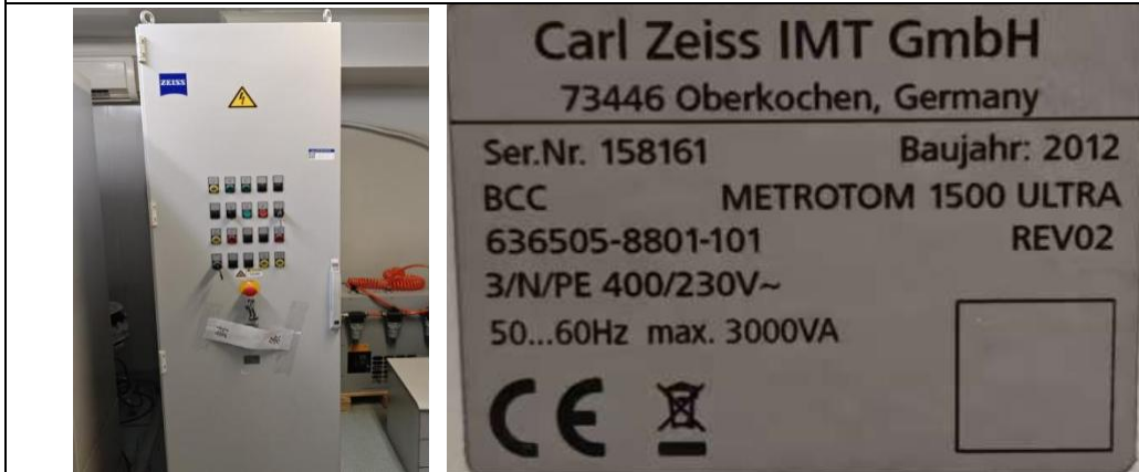
(3) 设备控制柜；设备铭牌
